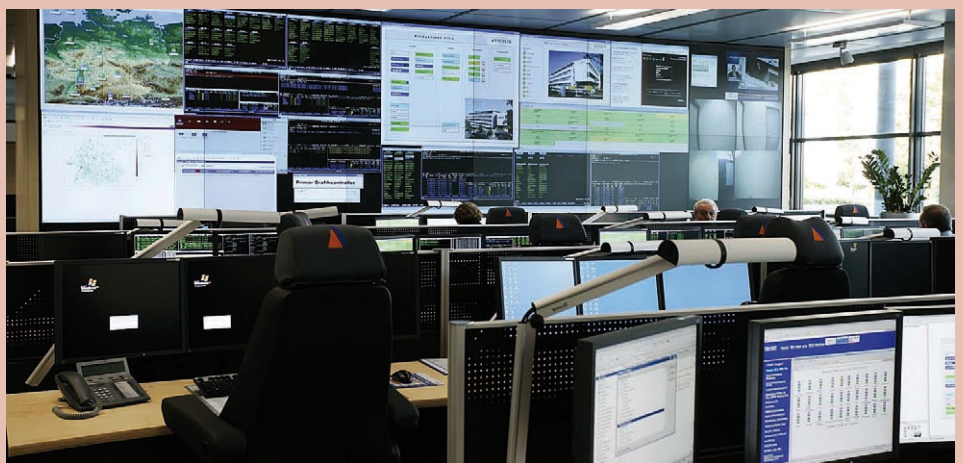
Abbildung 1: Hochmoderner Leitstand des Rechenzentrums der Fiducia
